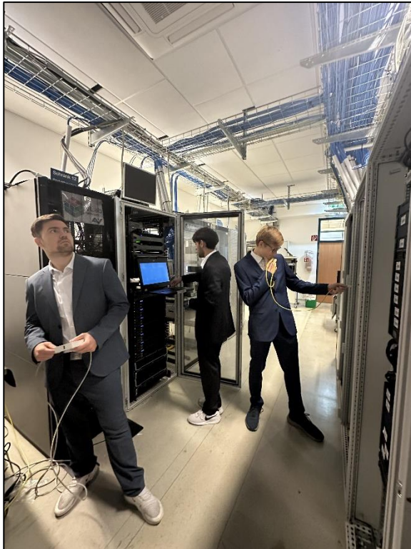
Abbildung 53: Chaos im Serverraum
